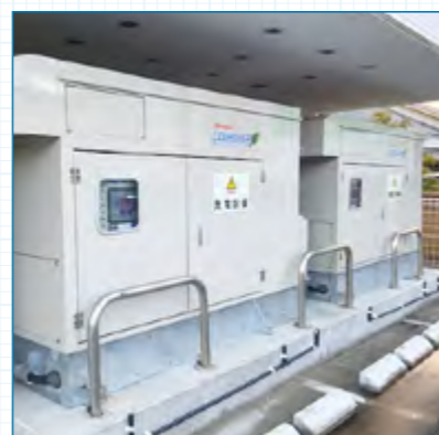
非常用発電機
