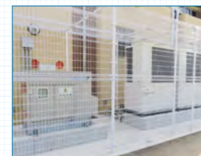
GHPと非常用発電機
