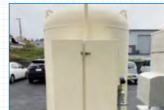
災害バルク貯槽
