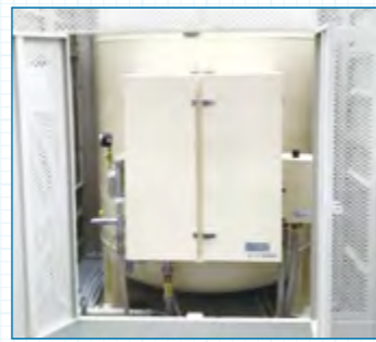
災害バルク貯槽
