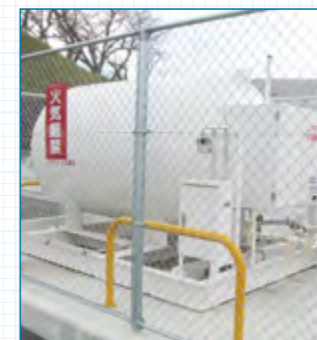
災害バルク貯槽
