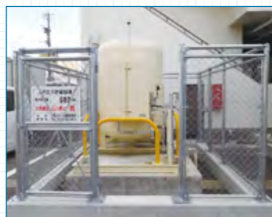
災害バルク貯槽
