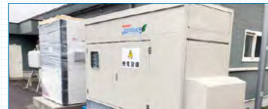
非常用LPガス発電機
