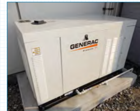
非常用発電機
