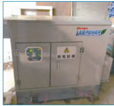
非常用LPガス発電機
