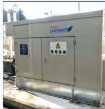
非常用LPガス発電機
