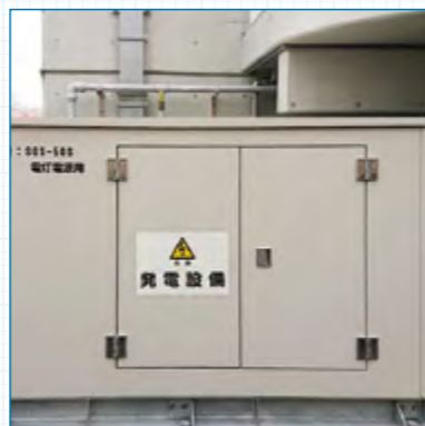
非常用発電機
