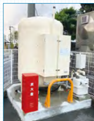
災害バルク貯槽
